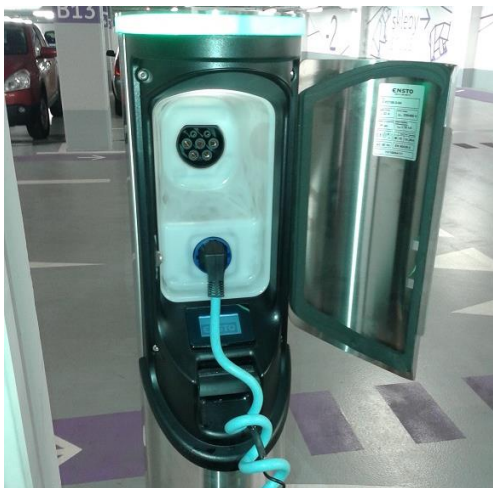
Rys. 2. Stłpek parkingowy do ładowania pojazdów elektrycznych w jednym z lubelskich centrów handlowych
